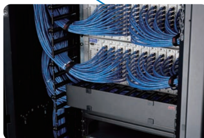
水平ケーブルマネージャ (AR8600A) カバーが付いた状態
